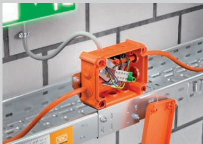
FireBox instalada com placa de montagem no caminho de cabos em chapa.
