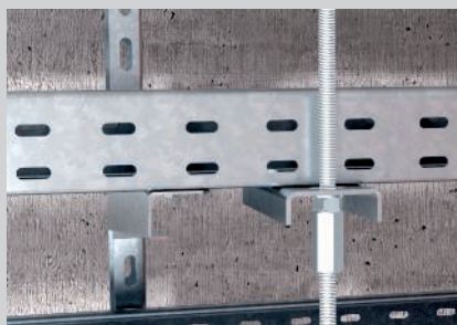
Fixação do varão roscado no caminho de cabos em chapa com disposição multiníveis.
