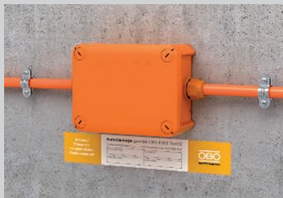
FireBox já instalada com placa de identificação.
