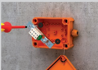
Instalação do parafuso de proteção contra incêndios, através da placa e base da FireBox.
