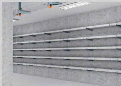
Túneis de cabos com envolturas em centrais elétricas.
