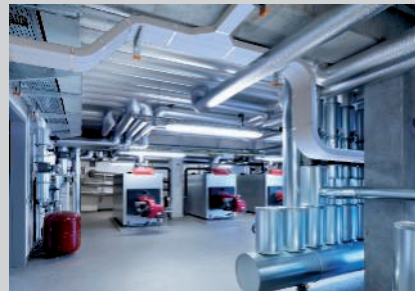
Utilização em sistemas de suporte em salas de fornecimento de energia ou unidades de produção.
