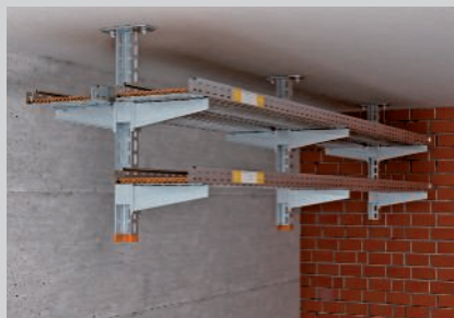
Instalação no teto dos dois lados com, no máximo, três níveis (2+1).
