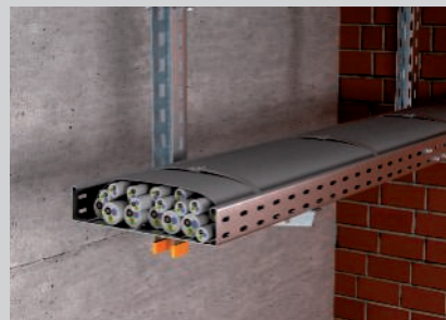
Fecho de um conjunto de cabos em sistemas de suporte.
