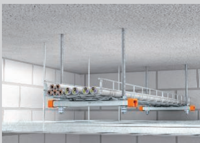
Instalação no teto de um nível, por cima do teto suspenso de proteção contra incêndios.
